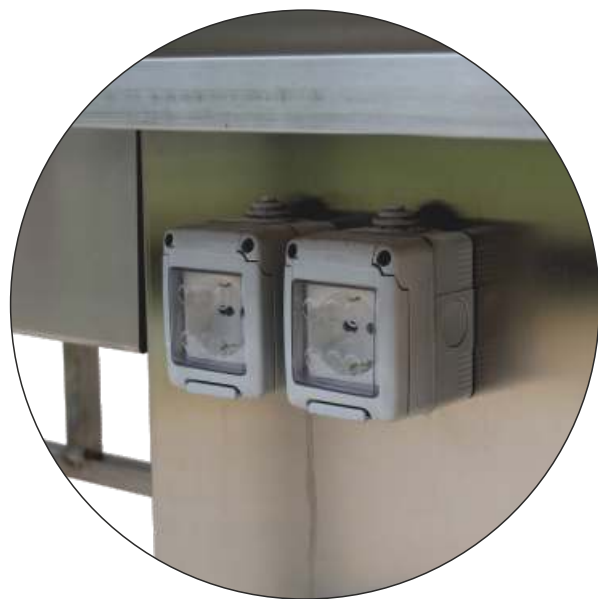
Due prese elettriche da 6A e 15A sulla colonna
